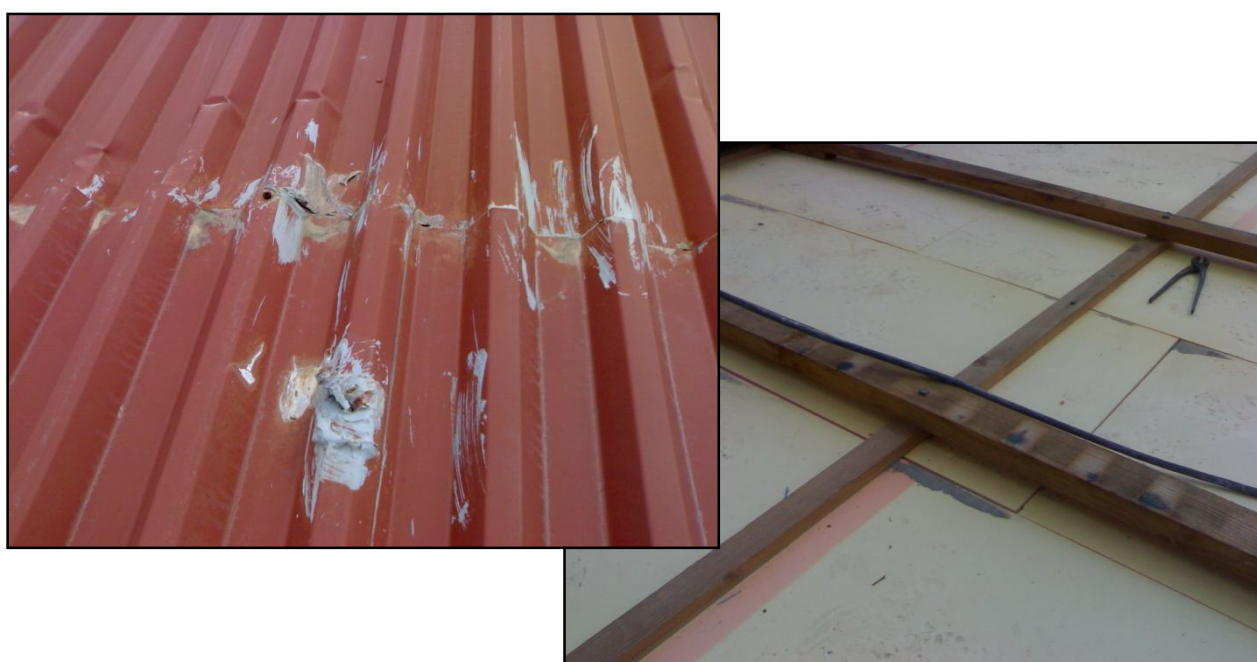
Particolari ammaloramento manto e sottostante orditura
