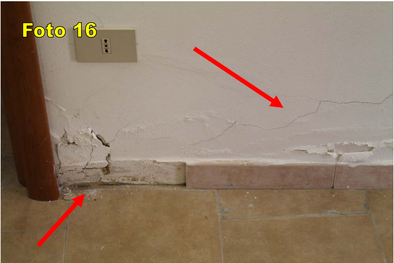
PORZIONE DI ZOCCOLINO MANCANTE ED INTONACO DEGRADATO
