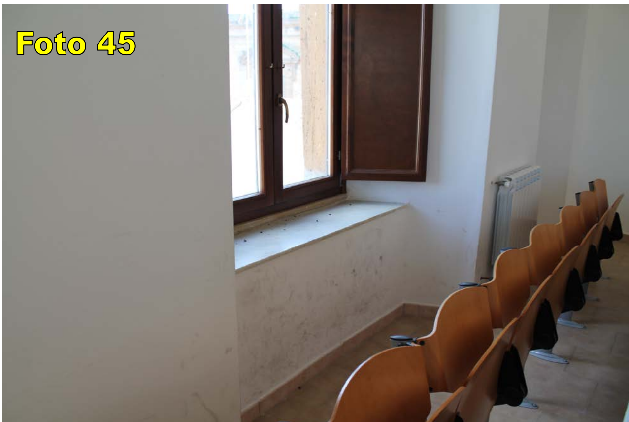
AULA 90 POSTI PIANO 2° – PARAPETTO FINESTRA INSUFFICIENTE (ALTEZZA 73 CM)
