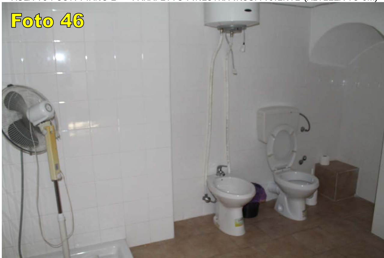
BAGNO DISABILI PRIVO DI SANITARI A NORMA E DI AUSILI PER PORTATORI DI ANDICAP
