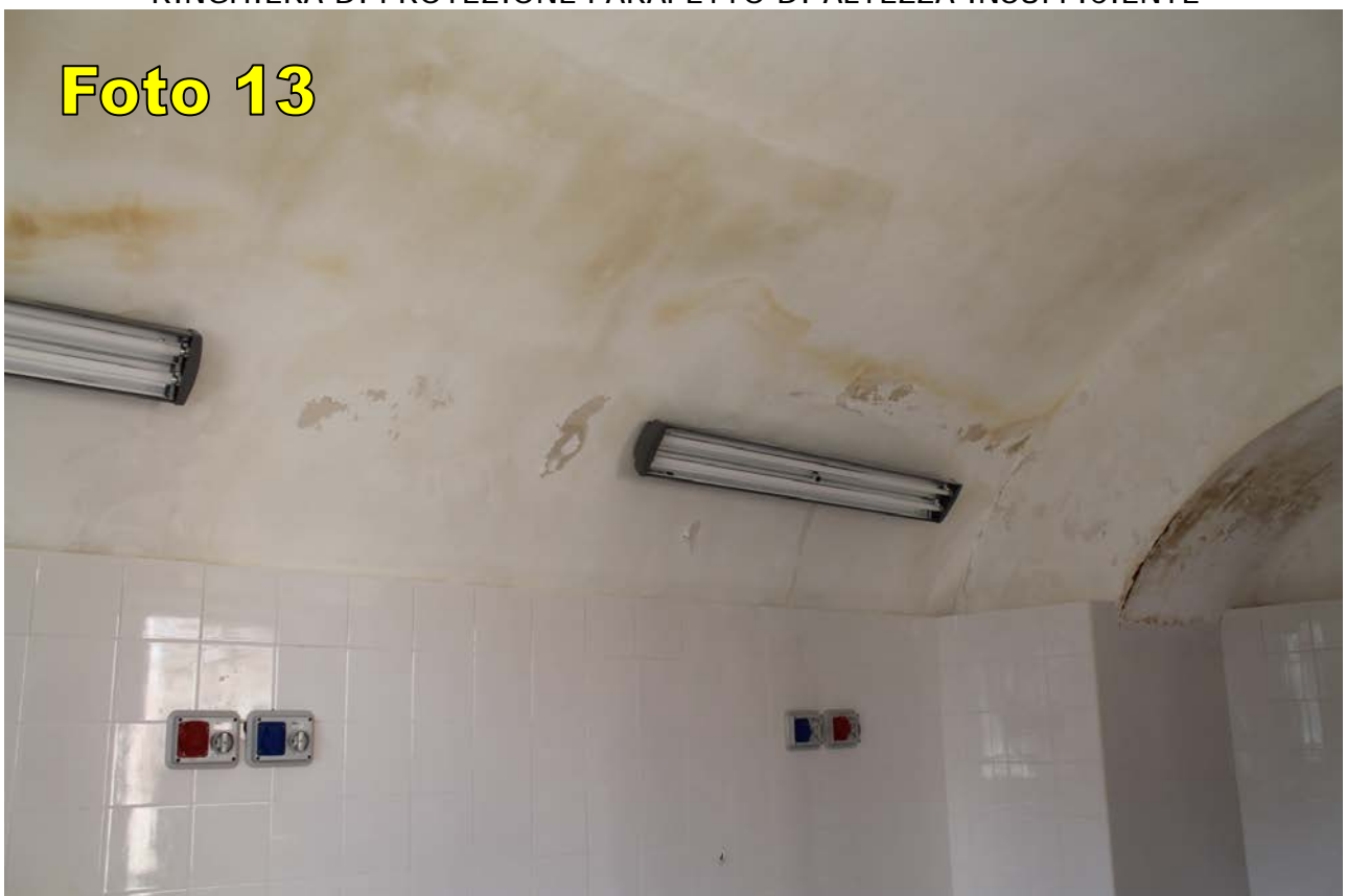
PRESENZA DI UMIDITA ALLE PARETI SOPRA IL RIVESTIMENTO
