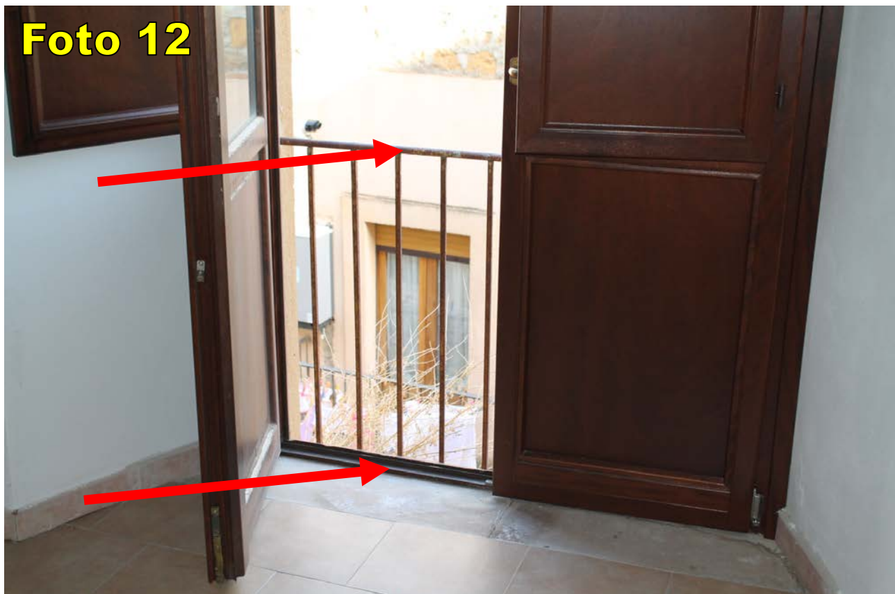
RINGHIERA DI PROTEZIONE PARAPETTO DI ALTEZZA INSUFFICIENTE
